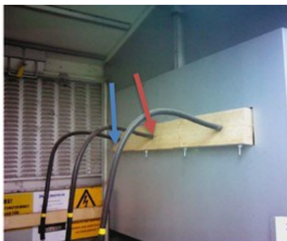
Genomföringar genom träregel som leder till glimningar och varmgång på säkringssidan.
