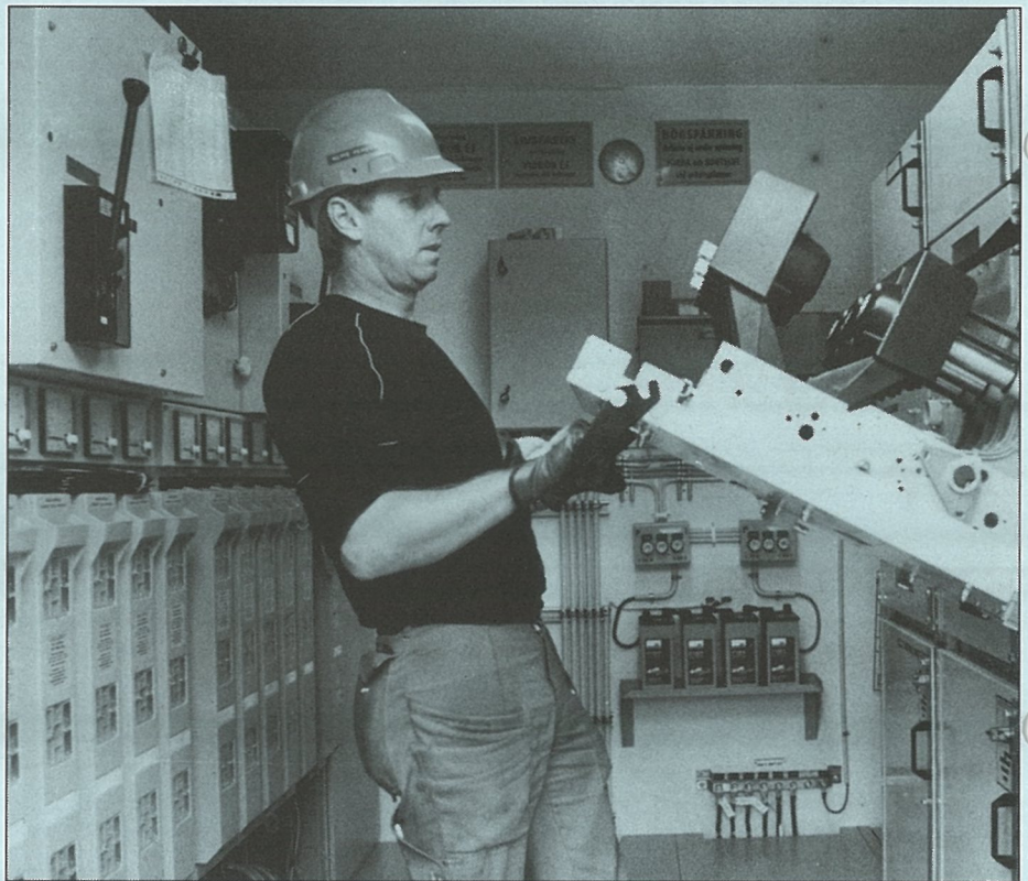
För att elverken ska kunna konkurrera om arbetskraften i framtiden måste nätstationerna vara moderna, säkra och enhetliga.
